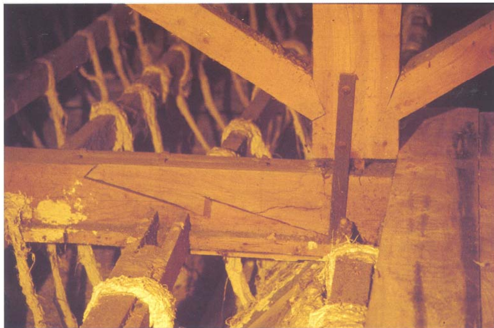
Figura 1.7 Empalme de rayo de Júpiter con refuerzo metálico. Se aprecia fenda o posible inicio de rotura.
