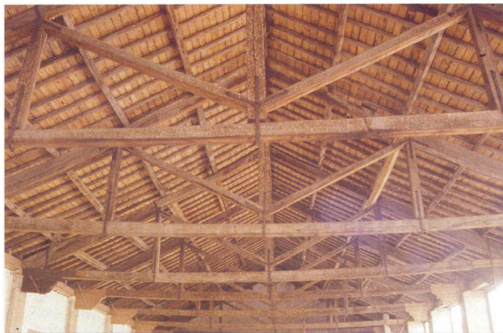
Figura 1.8 Deformación excesiva de una cercha originada por deslizamiento de las uniones entre par y tirante.
