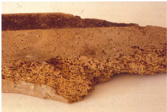
Figura 1.2 Daños producidos por anóbidos.
