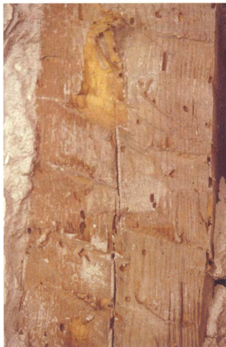
Figura 1.3 Daños producidos por cerambícidos.
